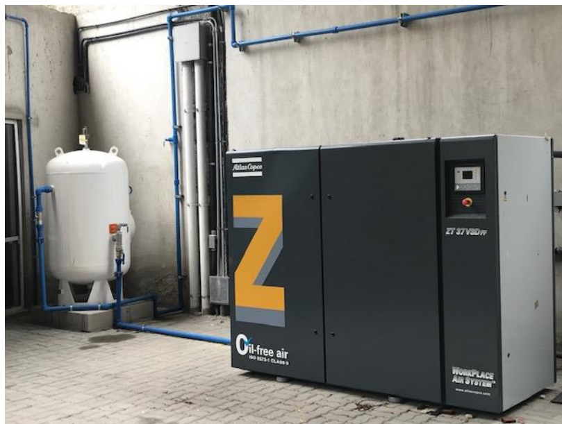
Figura 5: Compressor de ar de elevada vazão para estudos de escoamento multifásicos em dutos.
